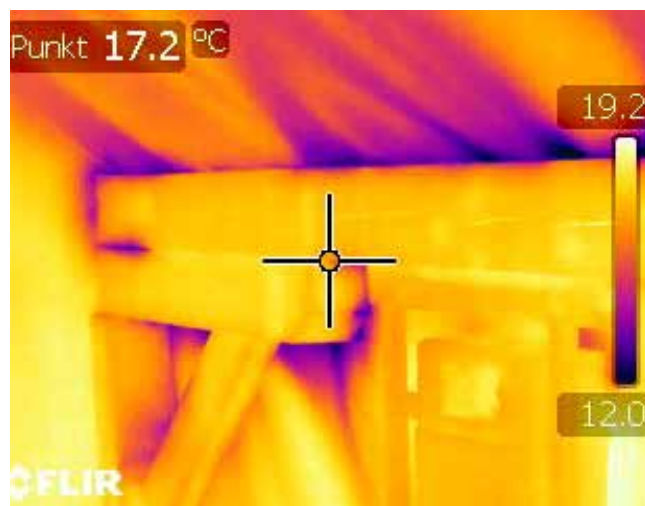
Rysunek 8.2 Straty ciepła, spowodowane infiltracją zimnego powietrza widoczne na zdjęciu termowizyjnym. Strumień zimnego powietrza przedostający się do budynku na styku belki, dachu i ścianki kolankowej, jest widoczny jako kolor niebieski
