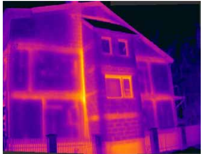
Rysunek 6.7 Zdjęcie termowizyjne budynku mieszkalnego z widocznymi mostkami cieplnymi – kolor pomarańczowy, spowodowanymi przez słupy, wieńce stropowe, nadproża okienne, kąty
